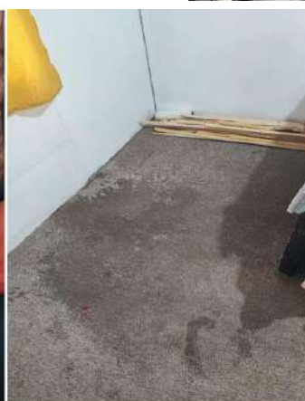
INTERIOR DE LAS VIVIENDAS DESPUÉS DE FUERTES LLUVIAS EN LA ZONA
