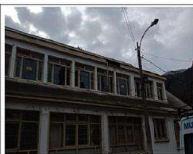
Figura 2. Deterioro de aleros y tapacanes
